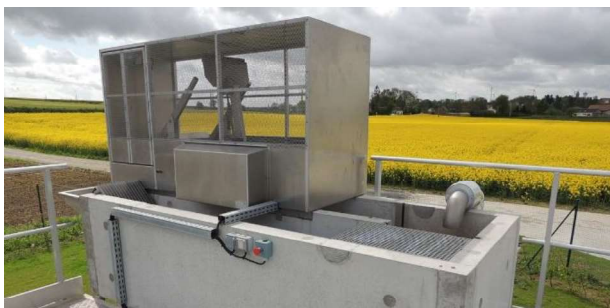
Dégrilleur station d'épuration de Brancourt - AEAP
