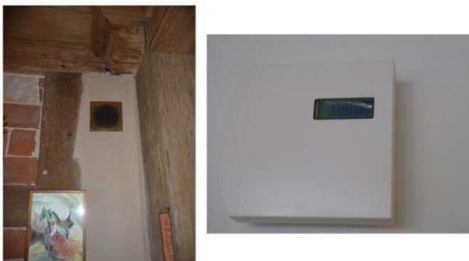
Bouche de ventilation en laiton - Détecteur de CO 2 dans une classe
